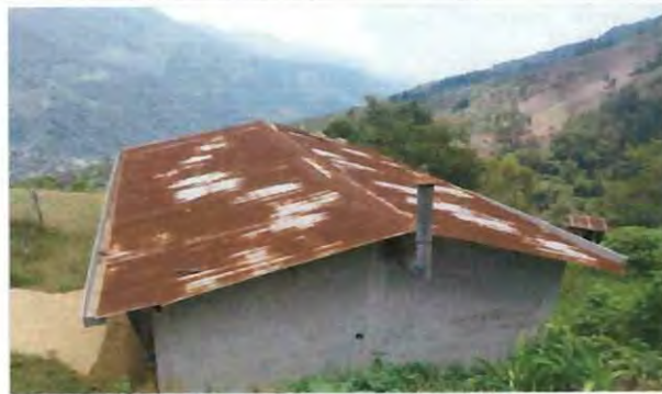
Foto 4: La cubierta de lámina se encuentra en mal estado, con láminas de zinc oxidadas de igual manera la estructura de techo.
