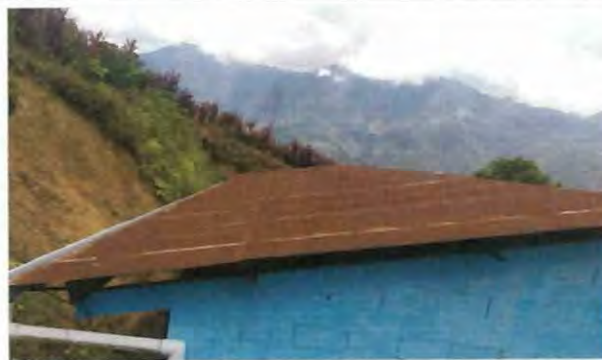
Foto 2: Situación actual de la cubierta de lámina, que además necesita mantenimiento de la estructura de techo.
