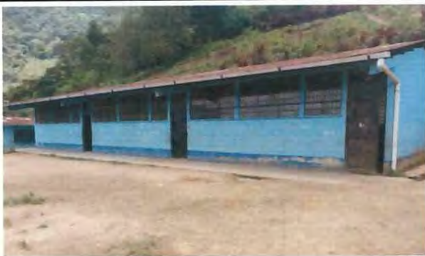
Foto 1: El módulo de las aulas amerita sustitución de cubierta de lámina de zinc, mantenimiento de paredes con aplicación de pintura, ladas calibre 26 y estructura de soporte de metal en el módulo de las aulas.
