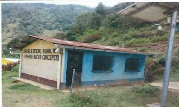
Foto 3: El módulo de cocina amerita sustitución de cubierta de lámina, de estructura de techo y aplicación de pintura en las paredes.
